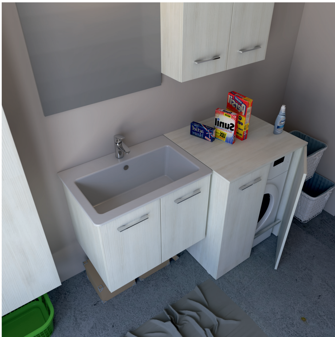
Comp. 30 - vasca lavatoio in ceramica
